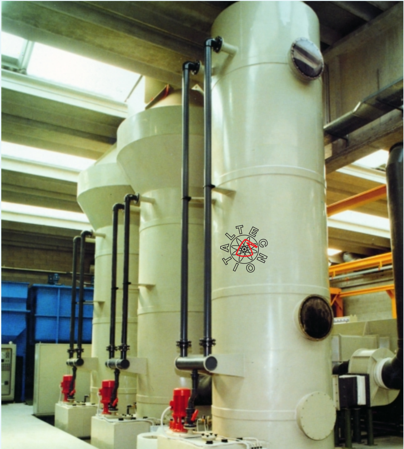
Esempio di torri di neutralizzazione per espulsione di fumi trattati, in conformità alle leggi vigenti
